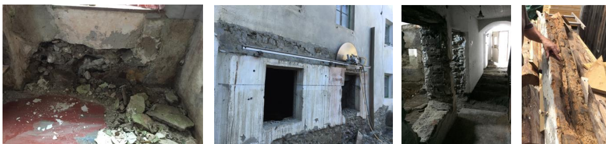
Abbildung 4-7: Feuchteschäden, Schleifen von Mauervorsprüngen, Durchbrüche, und verfaulte Holzbalken
