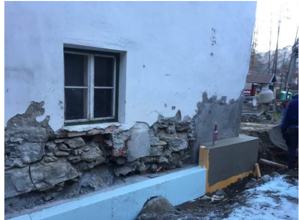
Abb. 2: Einrichtung Sockeldämmung, Einblick in das Bestandsmauerwerk
